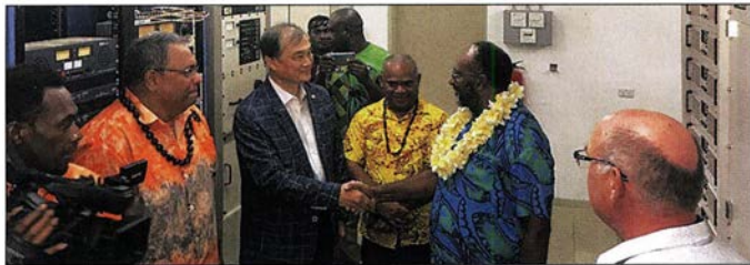
Hersteller und Premierminister (halb rechts) trafen sich zur Übergabe und offiziellen Inbetriebnahme des neuen Kurzwellensenders von Radio Vanuatu .
